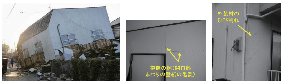
図 1 地震で倒壊した木造住宅（左）と、倒壊を免れた住宅において損傷を受けた内外装材（右）
