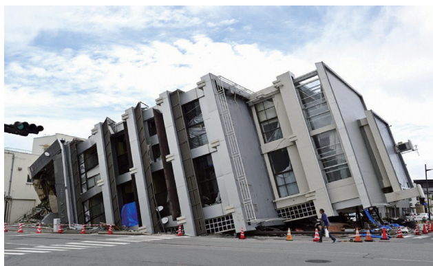
写真-1 2024年能登半島地震で倒壊した7階建てRC造(毎日新聞)
