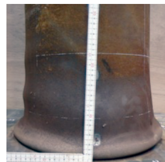
写真-5 鋼管コンクリート杭における鋼管の局部座屈
